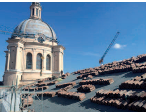
Basilica di Sant' Andrea, Mantova (di Leon Battista Alberti). Impermeabilizzazione su copertura a falde ad elevata pendenza con membrane bituminose incollate a fiamma e fissate meccanicamente.
