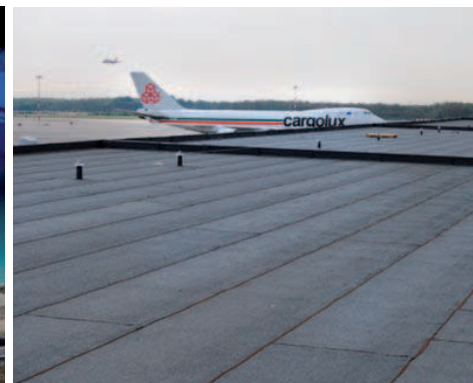
Malpensa Aeroporto (VA). Pensiline zona Cargo, impermeabilizzazione con membrane bituminose applicate a fiamma e linee vita.
